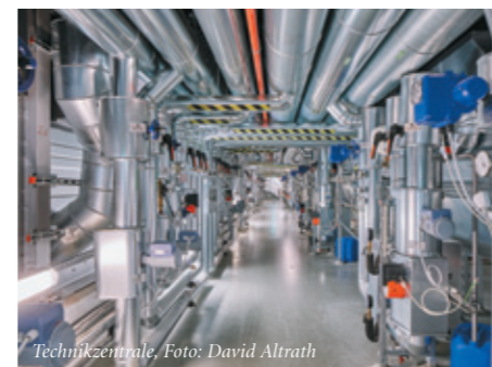
Technikzentrale, Foto: David Altrath
